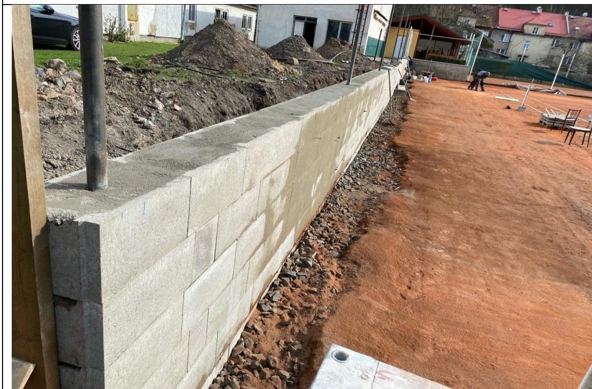
Tenisové kurty v Nádražní ulici ohraničuje od letošního roku nová opěrná zeď. Foto: web města.
